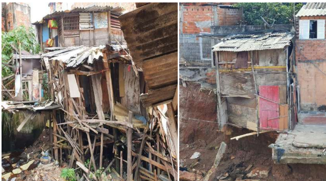
Desabamento de 6 barracos – Tanque – 16/03/2020; Desabamento barraco – Promorar – 18/03/2020.
