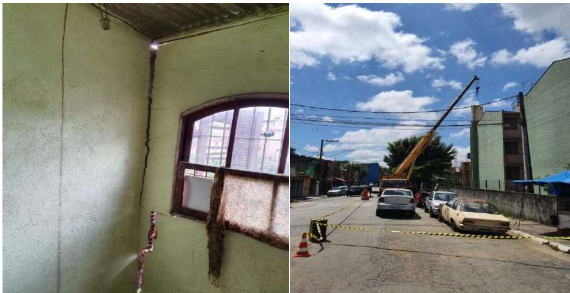
Risco de Desabamento Residência – F. Juta - 13/02/2020; Desabamento Caixa D'água – Jd. Sta. Adélia – 14/02/2020.
